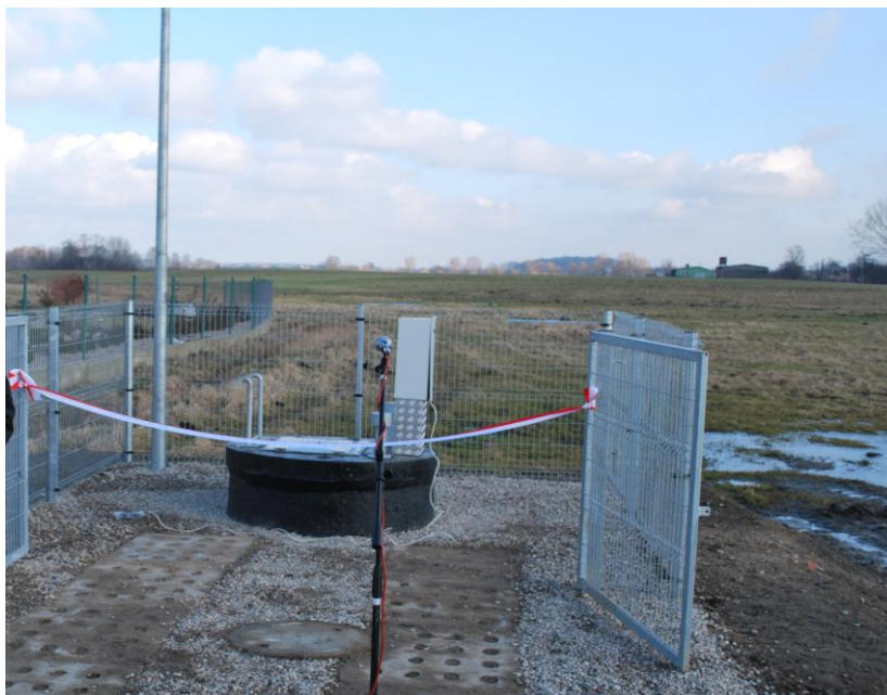
Zdjęcie przepompowni ścieków zlokalizowanej przy drodze gminnej Nowa Wieś – Kamień Duży
